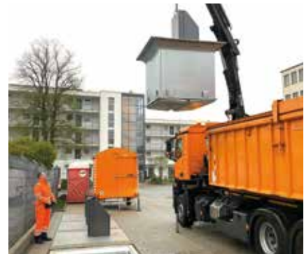
Am Leerungstag hebt ein Containerfahrzeug die gesamte Einheit mit einem Kran an und entleert den Container über Bodenklappen.
